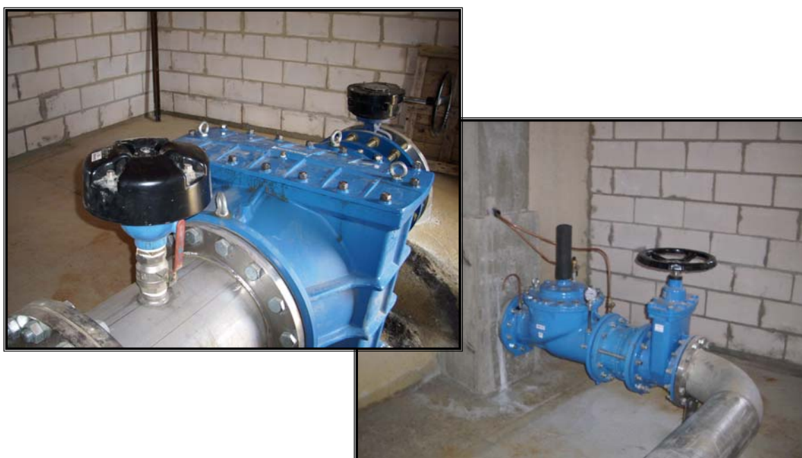
Figura 2. Valvulería y filtros para entrada de agua al depósito
