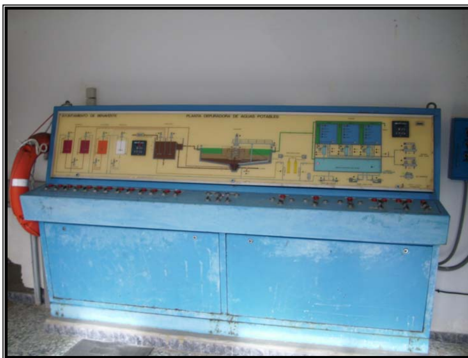
Figura 8. Mesa de control de equipos de la E.T.A.P.
