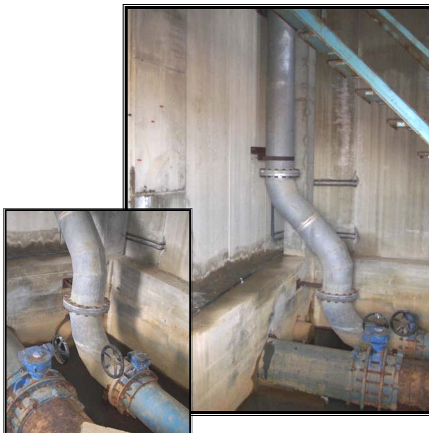
Figura 4. Tubería vieja de impulsión de diámetro \varnothing 400 mm de acero inoxidable
