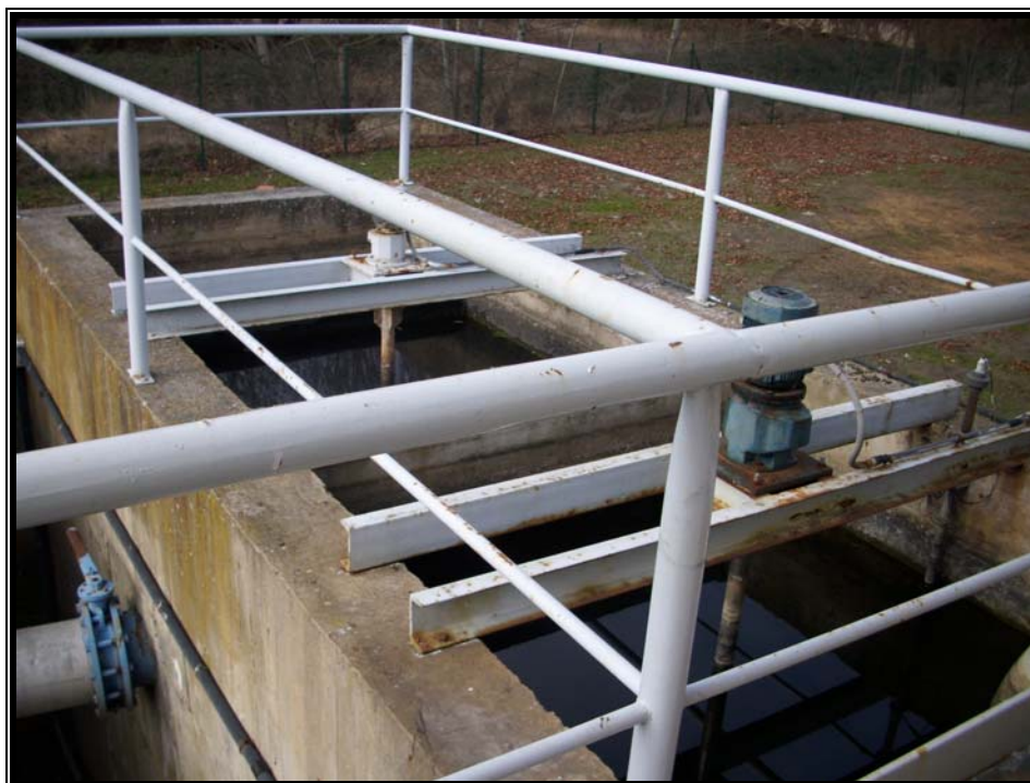
Figura 4. Arquetas de pretratamiento de la E.T.A.P.
