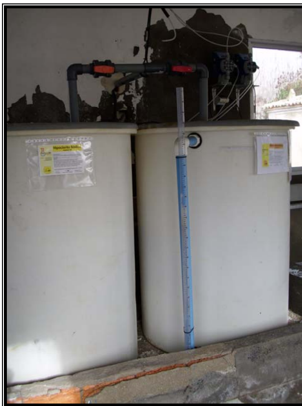
Figura 7. Depósitos de hipoclorito sódico de la sala de reactivos de la E.T.A.P.
