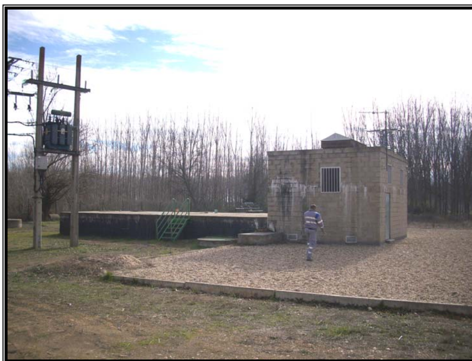
Figura 10. Depósito de almacenamiento de agua tratada y caseta de bombas de impulsión
