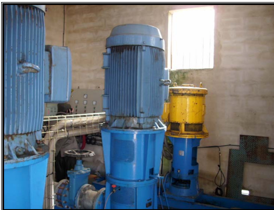
Figura 11. Bombas de impulsión
