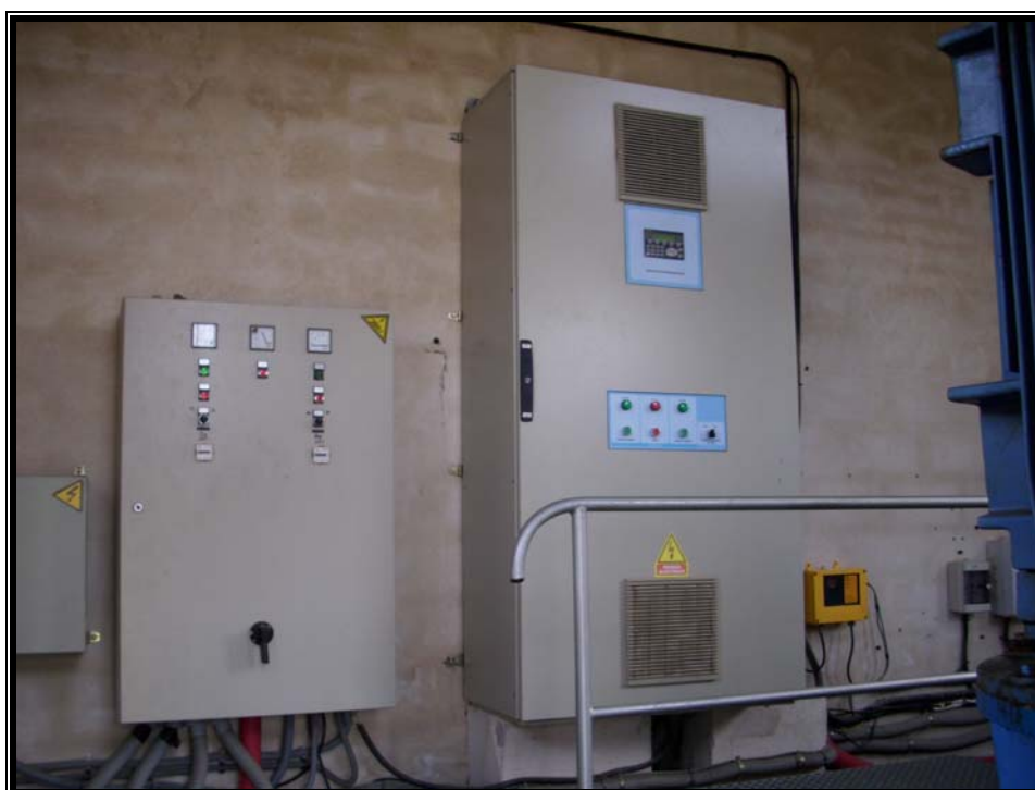
Figura 12. Cuadros eléctricos de las bombas de impulsión y cuadros de radio control
