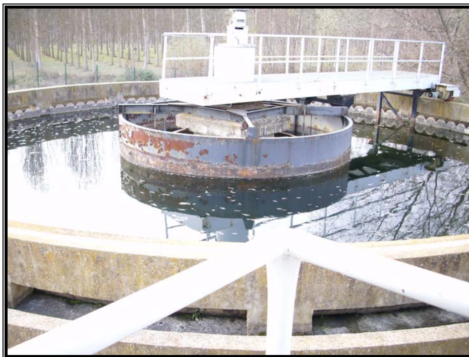
Figura 5. Decantador de la E.T.A.P.
