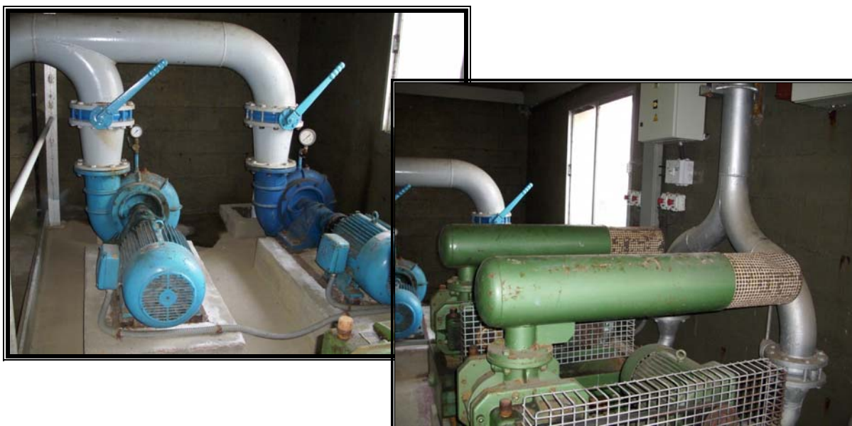
Figura 9. Bombas y sopladores de la E.T.A.P.
