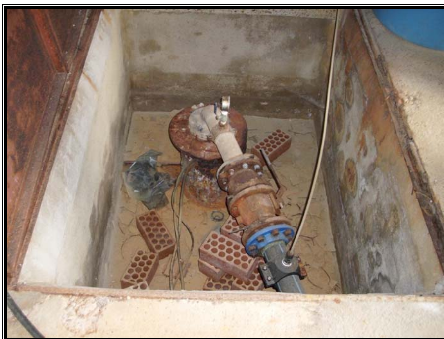
Figura 4. Sondeo y bomba de 100 CV para abastecimiento del depósito
