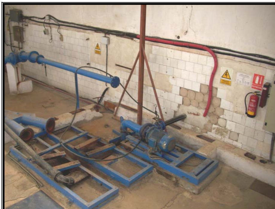
Figura 2. Bomba instalada en la Casa de Aguas
