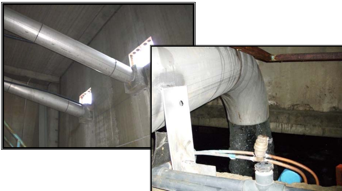
Figura 3. Tuberías nuevas de impulsión de diámetro \varnothing 300 mm de acero inoxidable
