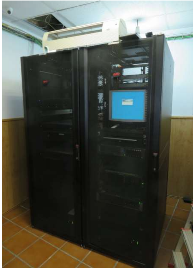
Imagen Nº 8: Armarios de servidores a trasladar a Av el Ferial
