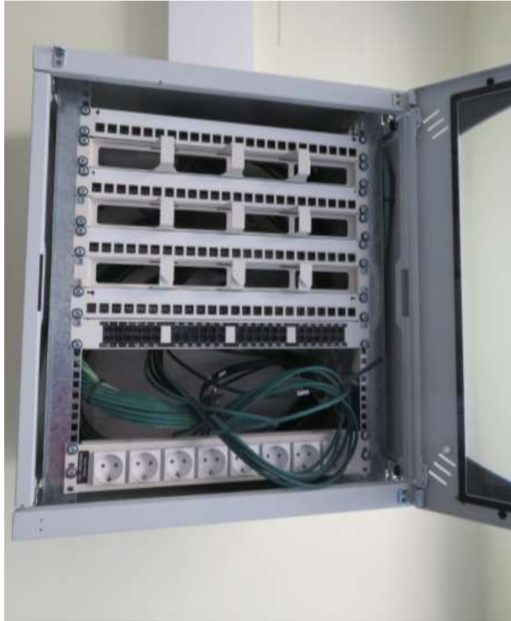
Imagen N° 3: Armario Rack de Planta Tercera
