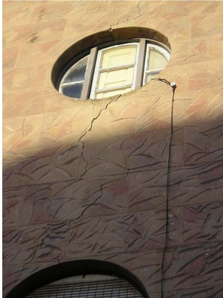
IMAGEN 3.- GRIETA SOBRE VENTANA CIRCULAR DE PLANTA 1ª. EXTERIOR
