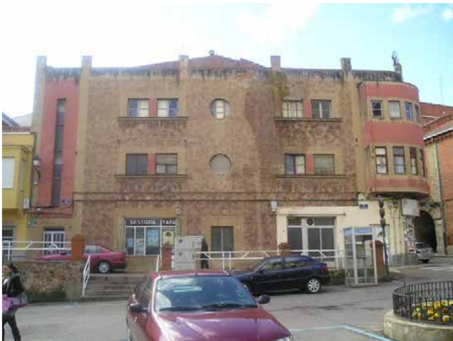
Estado actual de la fachada a la plaza San Francisco, pudiendo apreciar humedades
