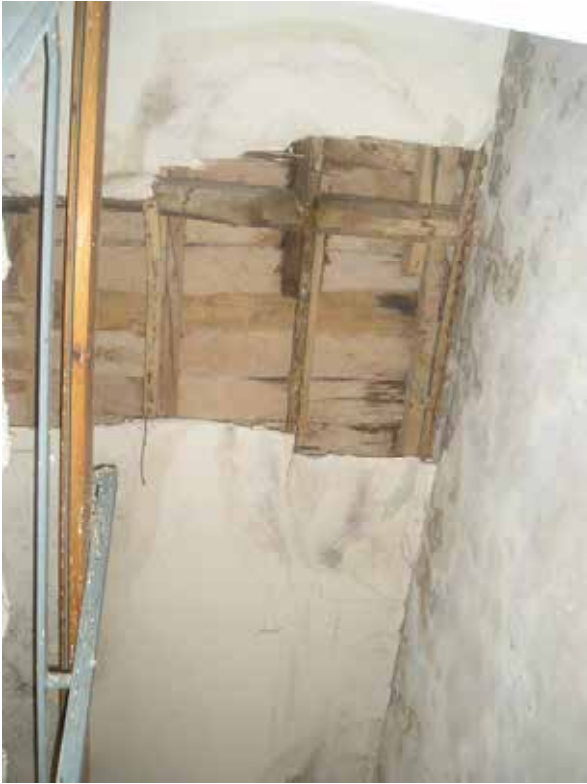
Detalle de desprendimientos
