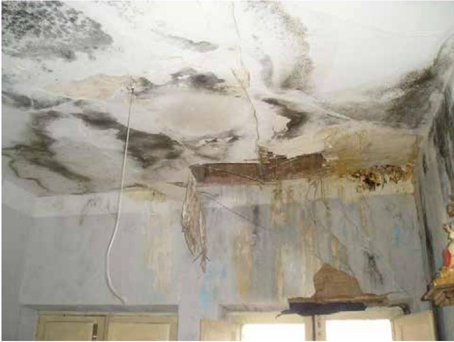
Detalle de humedades y desprendimientos
