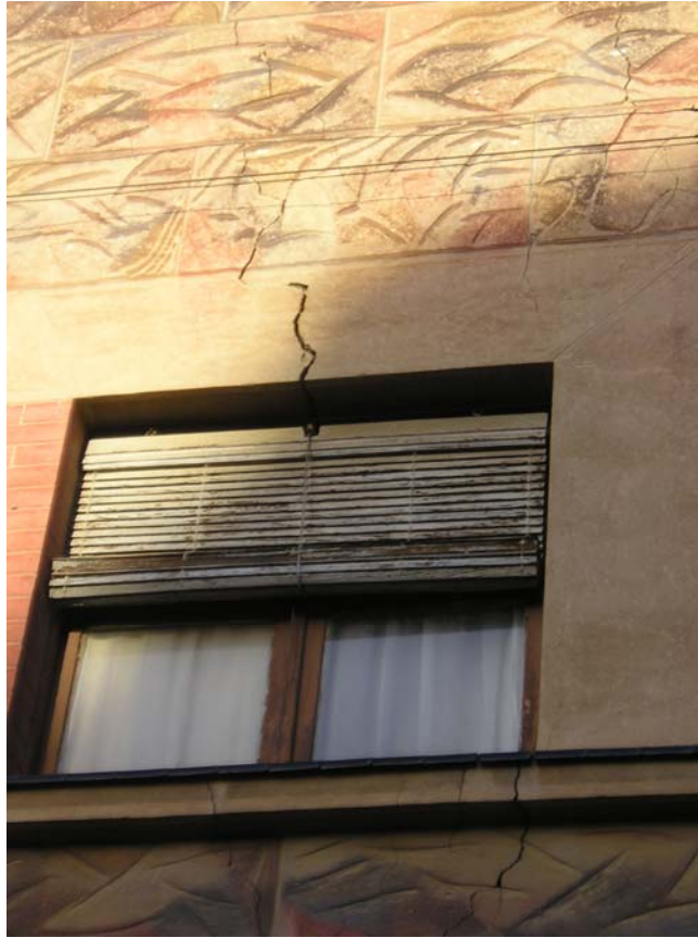
Detalle de grietas y figuraciones de la fachada
