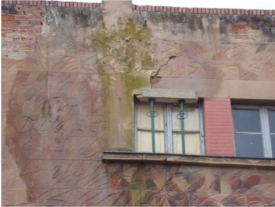
Detalle de humedades de la fachada de la plaza San Francisco
