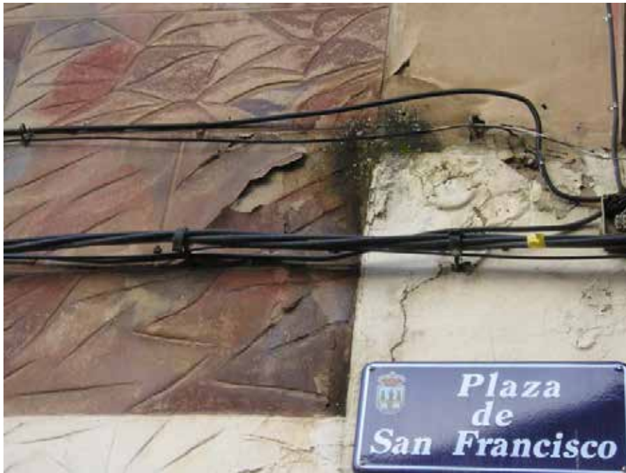
Detalle de desprendimientos de revocos simulando piedra.
