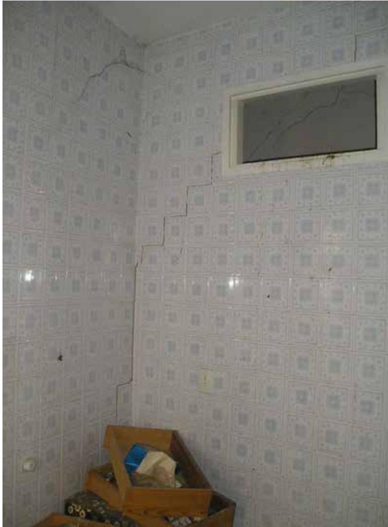
IMAGEN 14.- GRIETA EN TABIQUERIA INTERIOR. DETALLE DE CARPINTERIA AFECTADA POR LA GRIETA.
