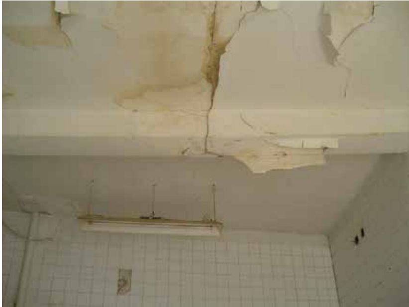
Agrietamiento de viga del forjado
