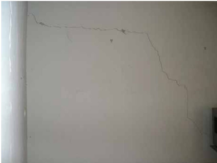
IMAGEN 13.- GRIETA EN TABIQUERIA INTERIOR
