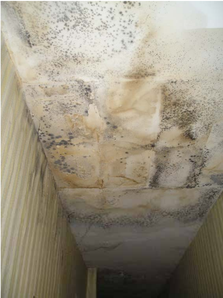
Detalle de humedades
