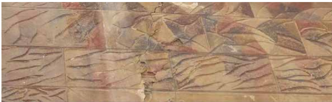
IMAGEN 9.- DESPRENDIMIENTO DE REVOCOS POR GRIETAS
