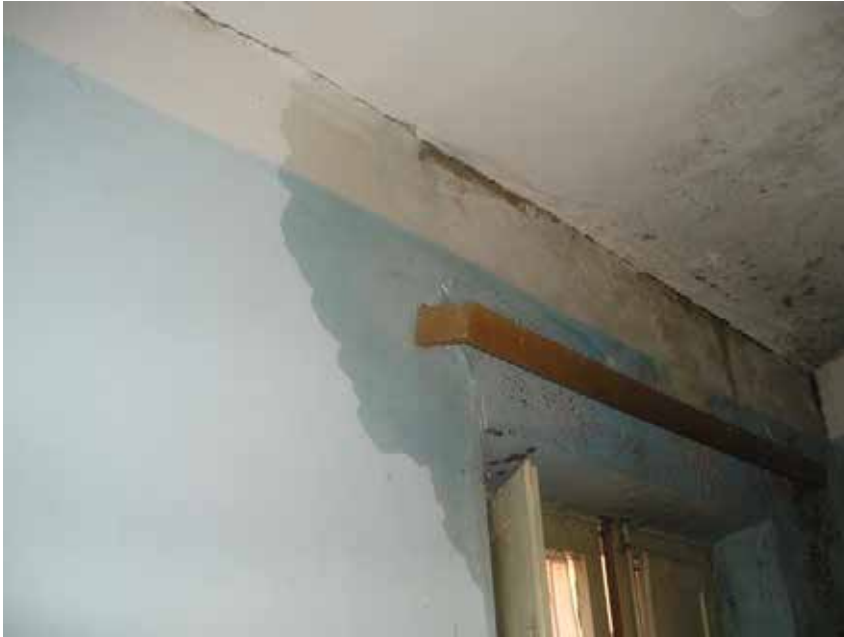
Detalle de humedades
