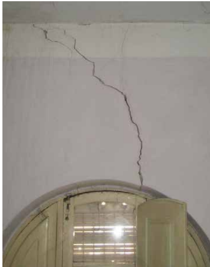
IMAGEN 2.- GRIETA SOBRE VENTANA CIRCULAR DE PLANTA 1ª. INTERIOR
