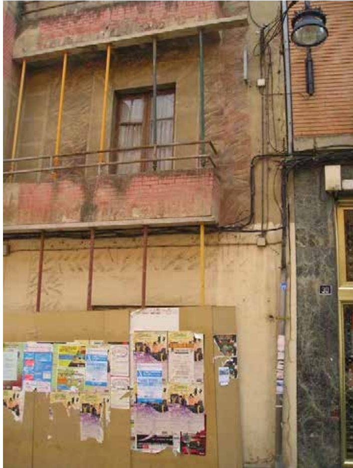
IMAGEN 10.- APUNTALAMIENTO DE BALCONES EN C/ DE SANTA CRUZ. DETALLE DE PROTECCIÓN DE PASO DE VIANDANTES.
