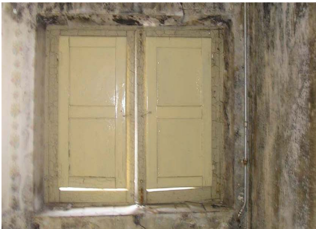
IMAGEN 7.- PUDRICIÓN PARCIAL DE CARPINTERIAS
