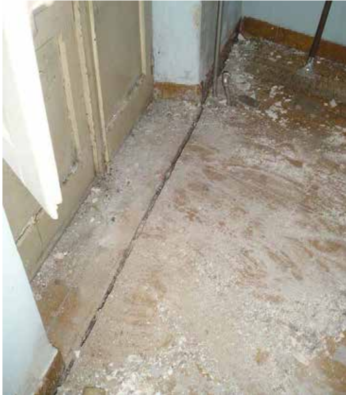
IMAGEN 4.- GRIETA EN PAVIMENTO
