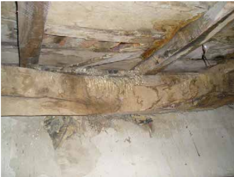
Detalle de humedades y roturas de estructura de cubierta
