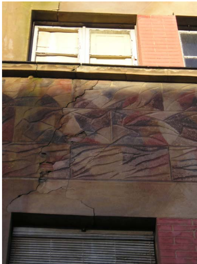
Detalle de grietas de fachada
