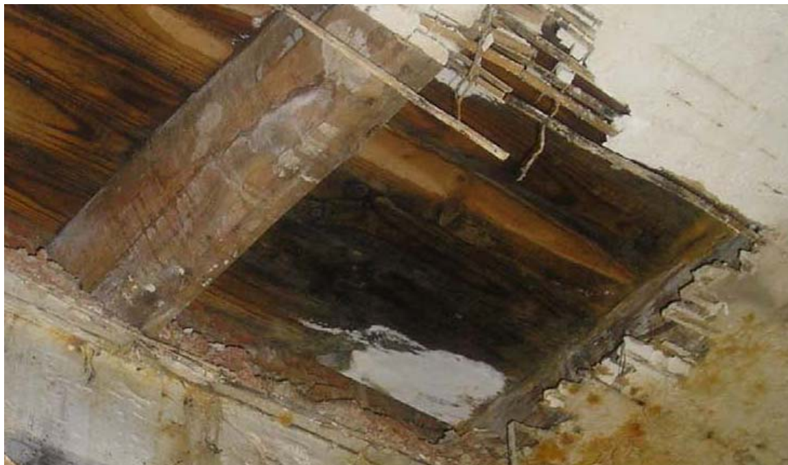
IMAGEN 6.- PUDRICIÓN DE ENTABLADOS DE MADERA Y VIGAS
