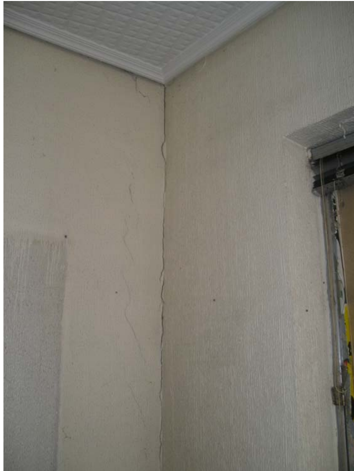
Agrietamiento de la pared de carga
