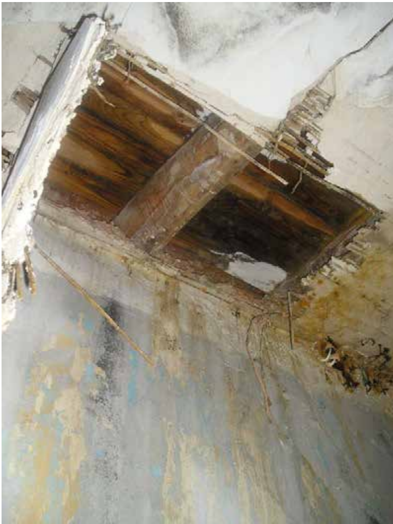
Detalle de humedades y desprendimientos
