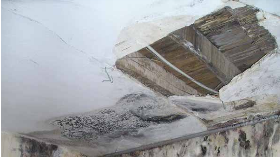
IMAGEN 12.- DESPRENDIMIENTO DE FALSOS TECHOS
