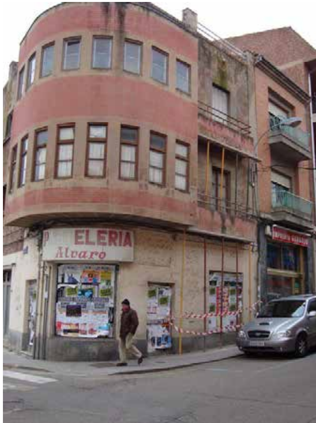
Estado actual de la fachada apuntalada por desprendimientos de material.
