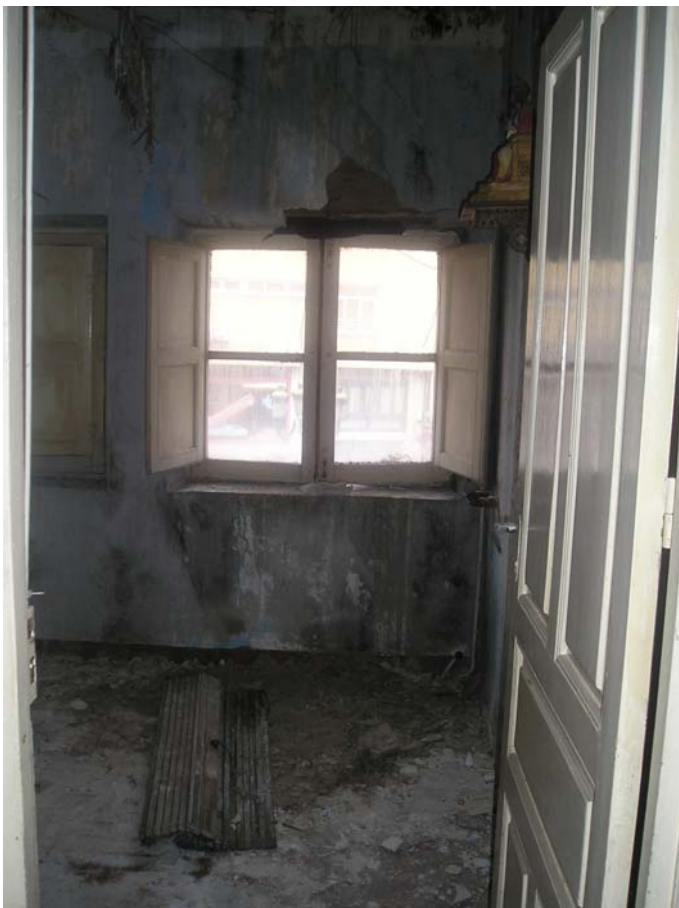
Detalle de humedades y desprendimientos
