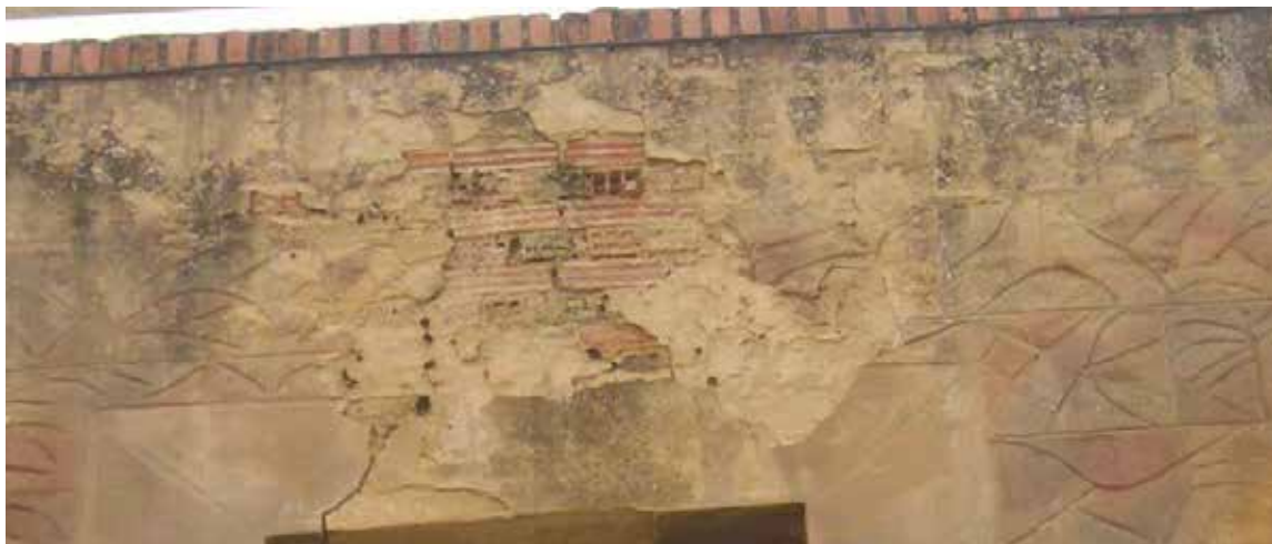
IMAGEN 8.- DESPRENDIMIENTO DE REVOCOS POR HUMEDAD
