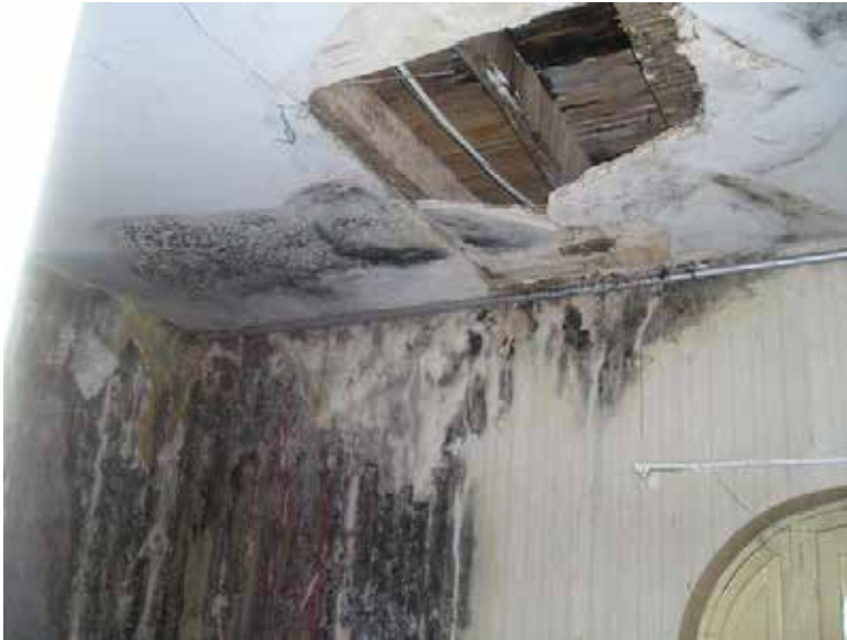
Detalle de humedades y desprendimientos
